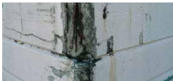
Une arête de mur était gravement endommagée.
