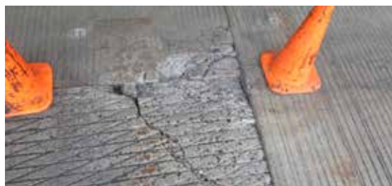
Un panneau de béton s'était fissuré, ce qui causait des problèmes sur la route.
